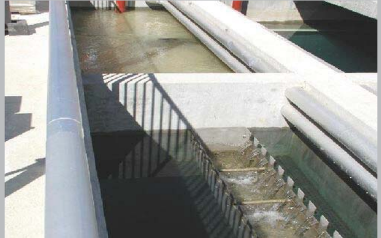
ACTIFLO effluent water troughs
